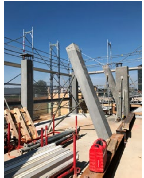
Der hochgehängte Geschossbereich über dem Perron im nördlichen Teil des Gebäudes ist ingenieurtechnisch eine spezielle Herausforderung. Über Zug-, Schräg- und V-Stützen war es möglich, eine derart weite Auskrugung zu erreichen.
